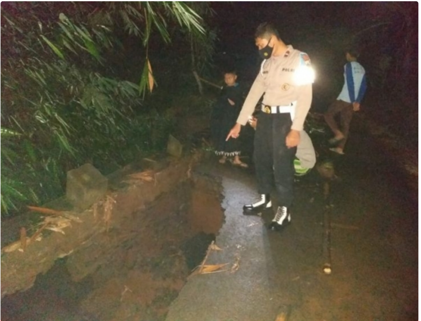
Hujan Deras Sebabkan Jalan di Pengadegan Ambles
